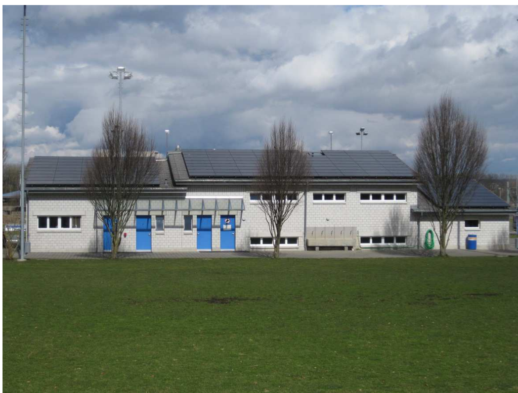
Neue Photovoltaikanlage auf dem Dach des Clubhauses des Fussballclubs
